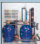
POOLUTRUSTNING Poolmodul för den stora poolen. Här med dubbla filterenheter. All pump och styrutrustning inkopplad och klar. Färdig att anslutas till poolen.
